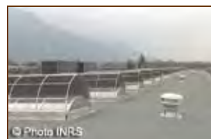
Exemple de protections solaires par l'extérieur en toiture + groupe de rafraîchissement d'aire (caissons noirs)
